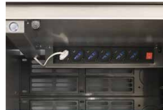
Mehrfachsteckdose bei allen TV-Elementen
