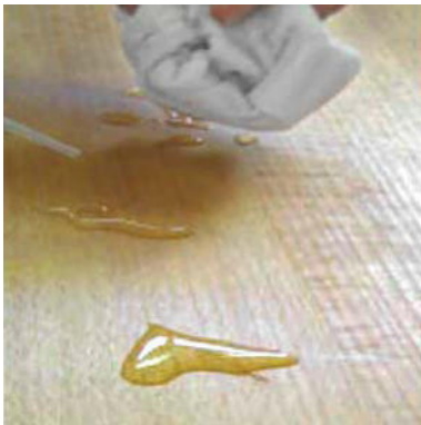
Wasser an schadhafter Stelle einwirken lassen
